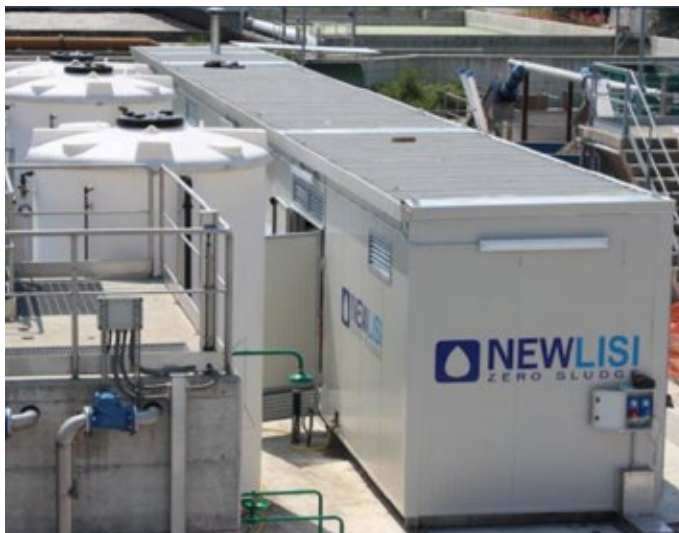
Di fianco un container dell'impianto sperimentale del sistema di abbattimento fanghi.
